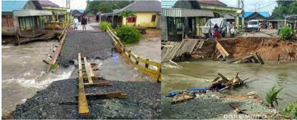
Gambar 2. Runtuhnya Jembatan Bawah Layung akibat banjir (sumber foto: Kominfo TALA)
